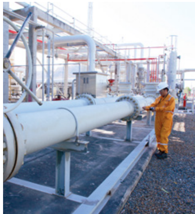
Hệ thống khí Hàm Rồng - Thái Bình
