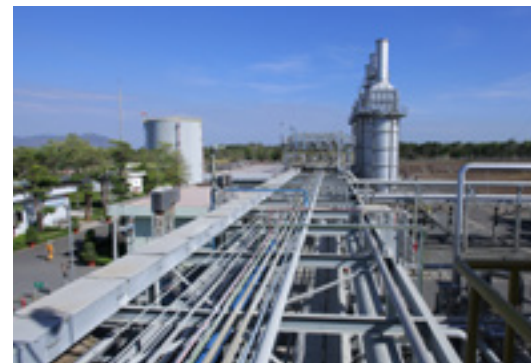
Nhà máy xử lý khí Dinh Cố
